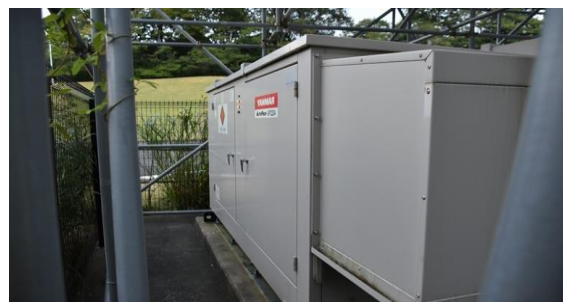
非常用発電装置
