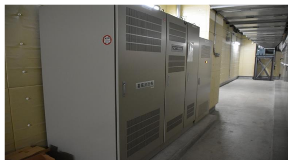
無停電電源装置
