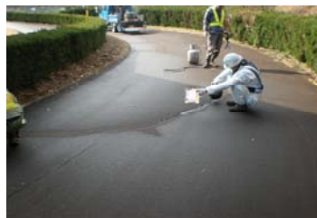
クラック補修
