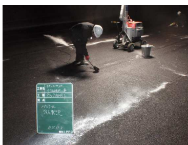
クラック補修
