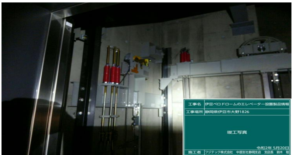
竣工 昇降路内
