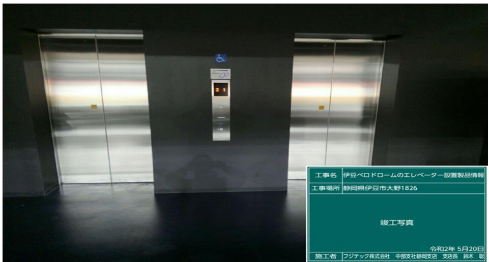
竣工 エレベーター2基
