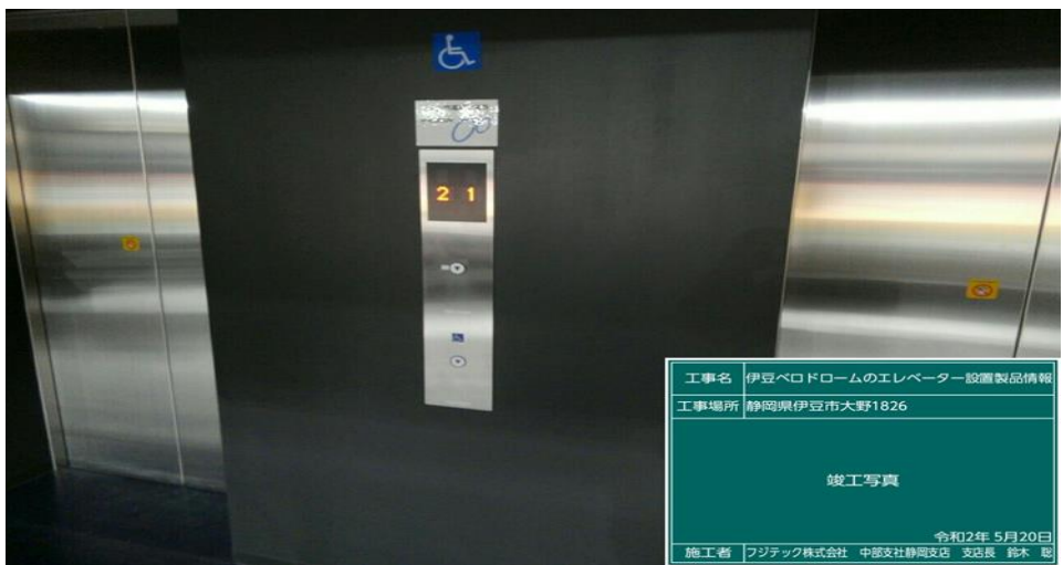
竣工 搭乗押しボタン
