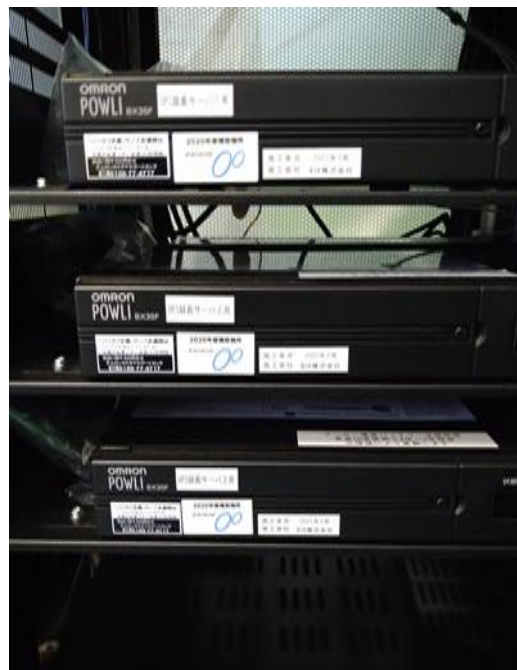
遠方監視装置（監視塔機器） ②
