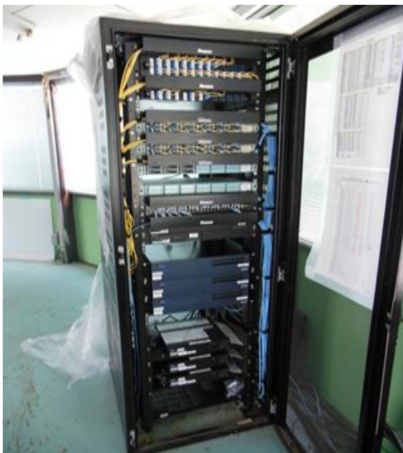
遠方監視装置（監視塔機器） ①
