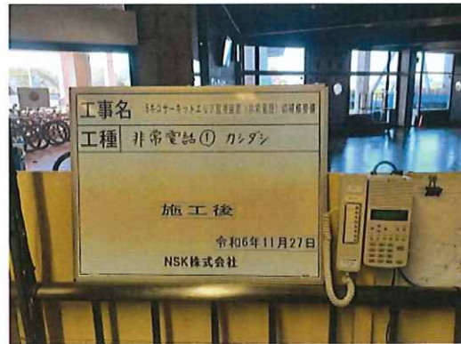
入替機器（非常電話）貸出場
