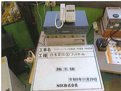
入替機器（非常電話）監視塔
